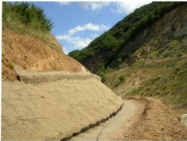
Crédit photo : SIBELCO Dispositif préventif de lutte contre l'érosion des sols
